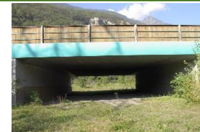
Pasos de fauna (facilita el cruce de la vía)
