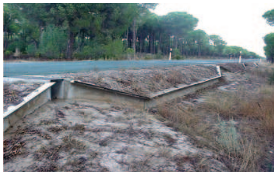
Figura 6.28. Perfiles metálicos para guiar a los anfibios hasta el paso. Foto: Junta de Andalucía.
