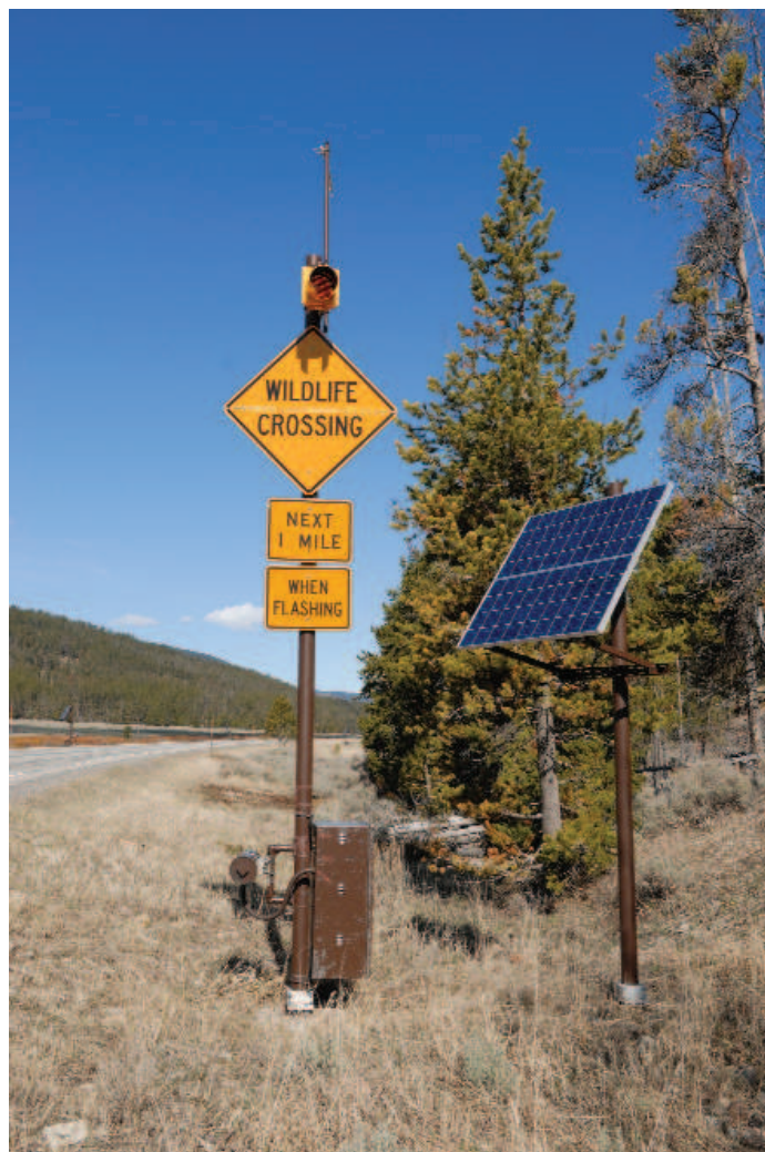
Figura 5.3. Señalización de advertencia en la que se ha instalado un sistema de sensor para la detección de fauna. Yellowstone National Park, Montana (USA). Foto: Marcel Huijser (WTI-MSU).
