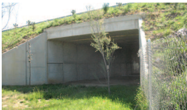
Figura 6.7. Paso de fauna y cerramiento perimetral instalados en un Tramo de Concentración de Colisiones con Ungulados de atención prioritaria. Foto: Minuartia.
