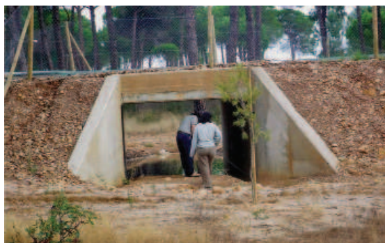
Figura 6.30. Paso específico para lince. Foto: Junta de Andalucía.
