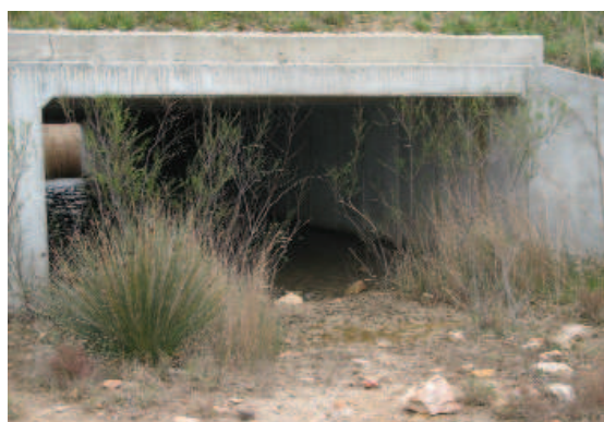
Figura 6.47. Paso de fauna bajo la carretera C-260. Foto: Minuartia.
